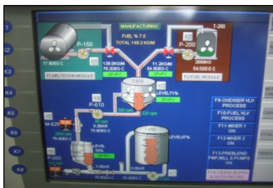
Рис. 3. Вид монитора центрального пункта контроля
